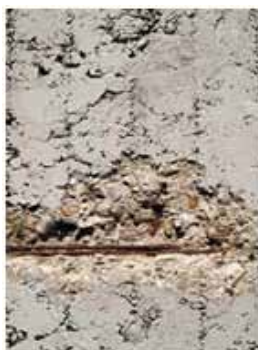
Figura 22 – Broca ou bicheira em elemento de concreto
