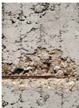
Figura 22 – Broca ou bicheira em elemento de concreto
